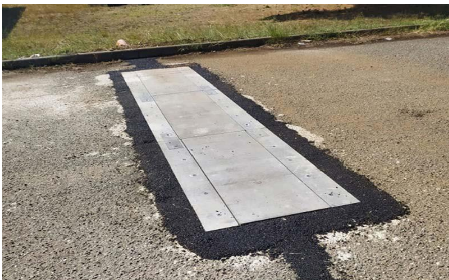
Figura 39 - Piastra meccanica collocata al livello stradale. Fonte: www.teknoiring.com .
